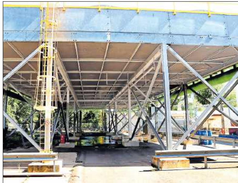
Detailaufnahme der großen Kühler des Kraftwerks Landau. ARCHIVFOTO: MERSEN
